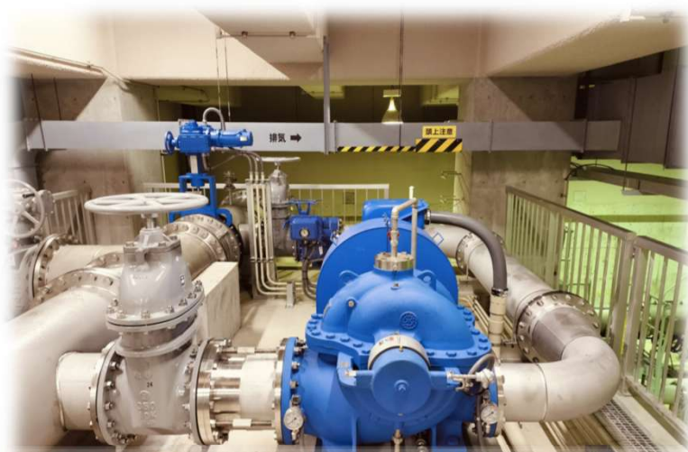
小水力発電設備(大乘寺丘陵配水池)
