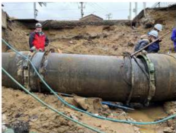
送水管の被害（七尾市）
