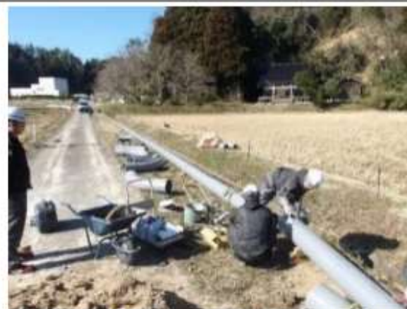
下水を集約し処理場にする圧送管の被災現場（珠洲市）
