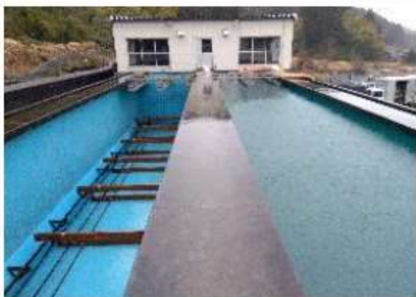
浄水場の被害（珠洲市）
