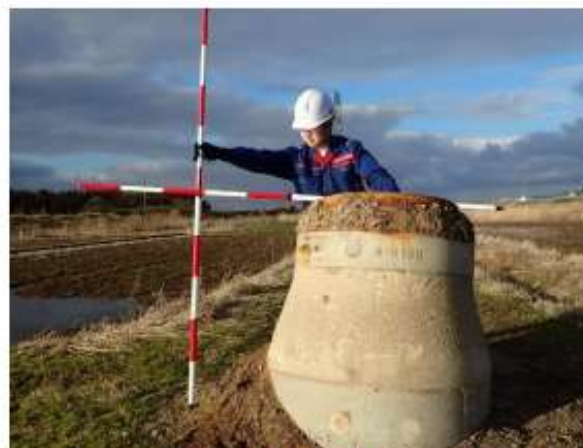
マンホール浮上現場（中能登町）
