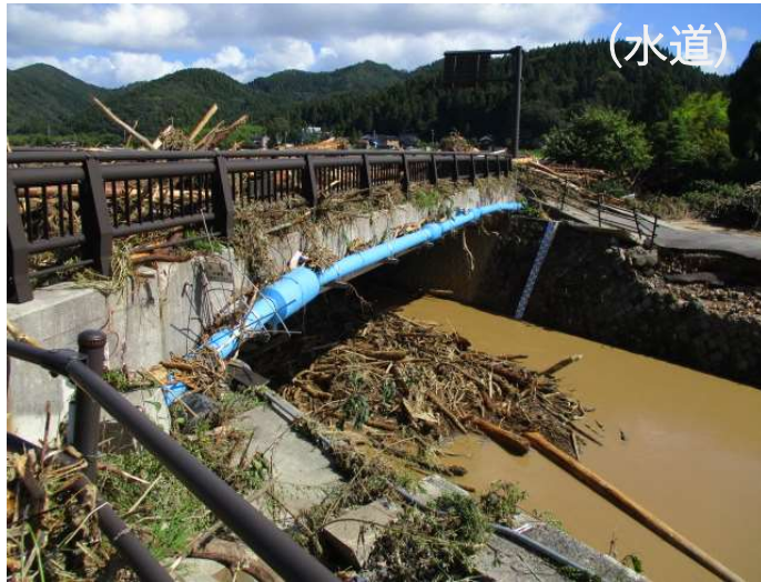
被害状況調査
