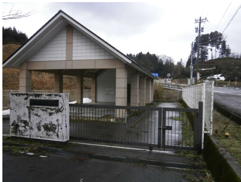
東原地区農村下水道処理施設
