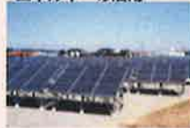
高山太陽光発電所 (太陽光パネル)
