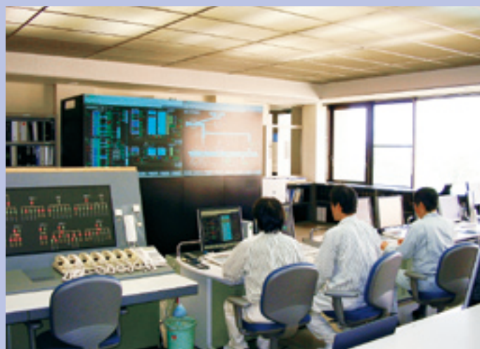
▼城北水質管理センター 中央監視室
