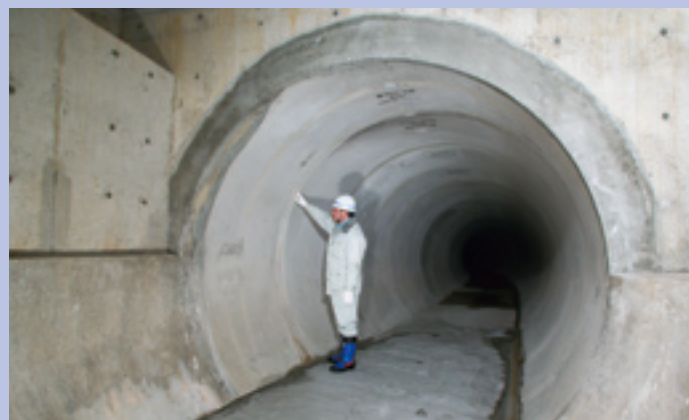
▼金沢駅周辺雨水増補幹線への流入管
